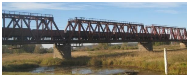
Рис. 1. Объект исследований – одноколейный металлический железнодорожный мост через реку Ворскла на 333-ем километре линии Киев – Харьков.
